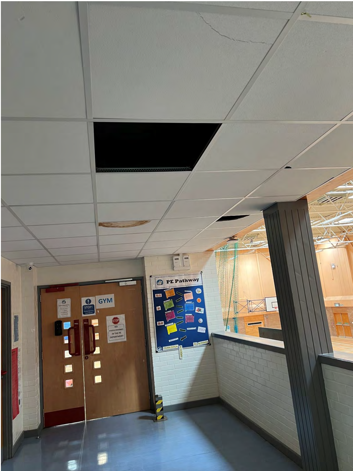
Photo N.19 - Extensive water staining to ceiling tiles (Community/gym block)
